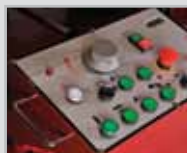
Painel de comando
